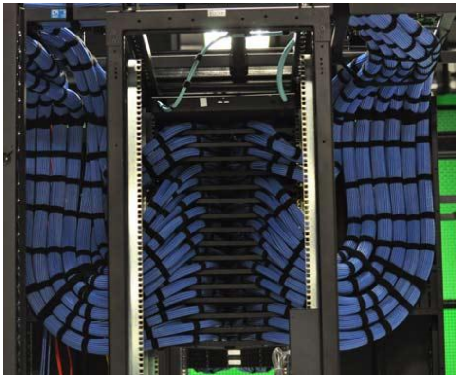
Slika 6.2.1: Kabliranje u data centrima [61]
